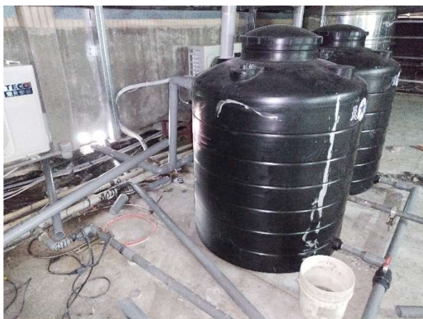
說明：行政大樓雨水收集桶
