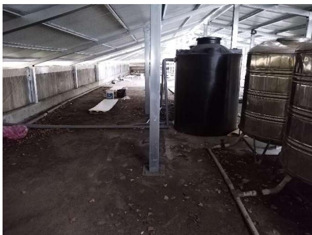
說明：仁愛大樓雨水收集桶(2)
