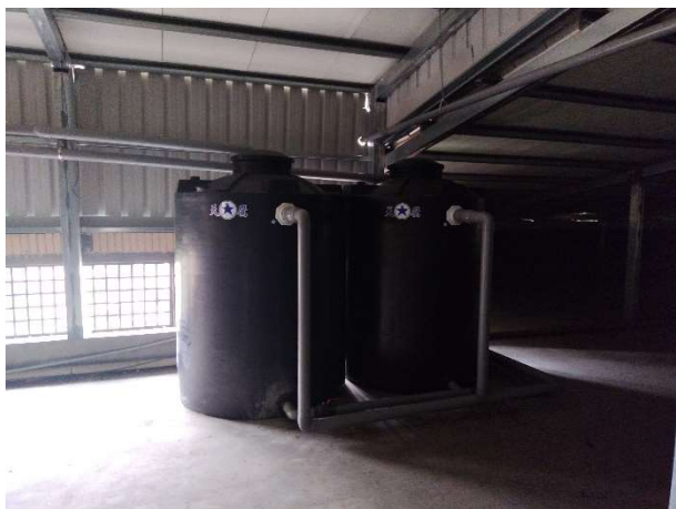
說明：仁愛大樓雨水收集桶(1)
