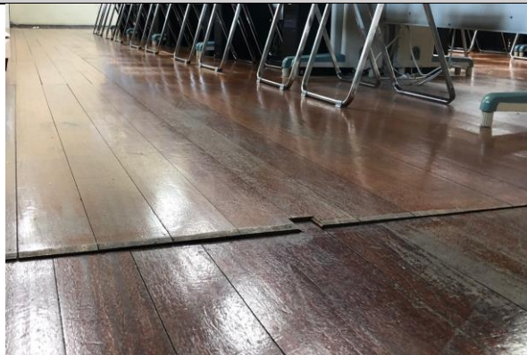
圖1原木頭地板經多年使用已出現高低差、塌陷與裂縫問題，師生於教室行走易生危險
