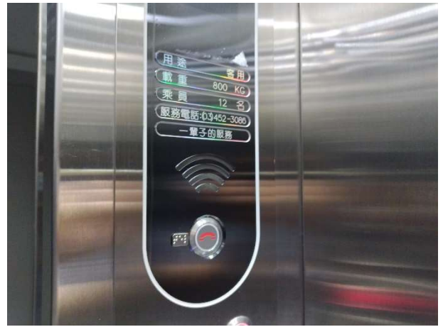
說明：圖書館電梯緊急對講機
