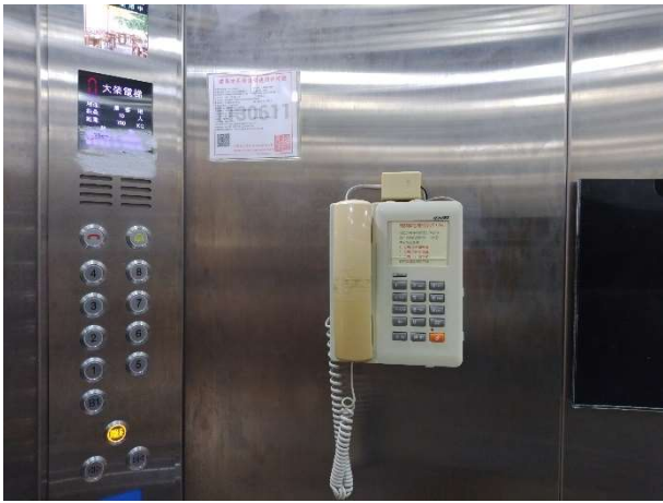
說明：資訊大樓電梯緊急對講機
