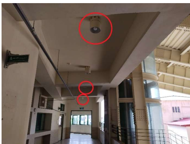
說明：志道大樓 5 樓走廊感應燈泡 (提供資源班教師夜間辦公行走之安全及便利性，亦可節省用電。)
